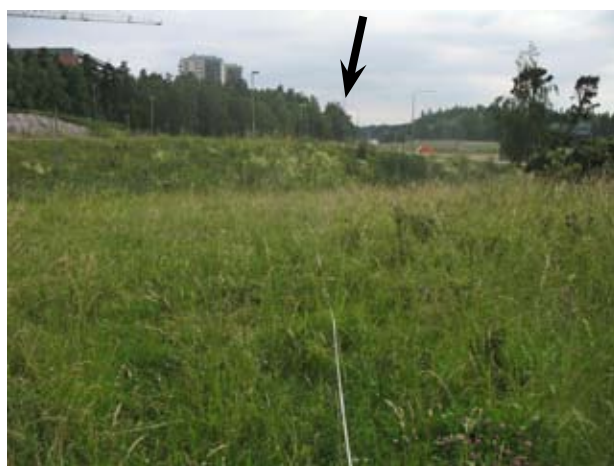
...och löper mot mitt i korsning hjulstavägen-akallavägen, nu under ombyggnad, men se också på sky-line (X=6588433, Y=1618351). Bilderna är alla från 2012.
