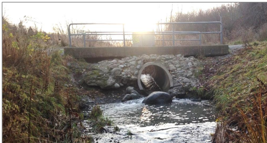
Sluttande kulvert under bro, Nälsta dike/bäck. Foto: Ekologigruppen
