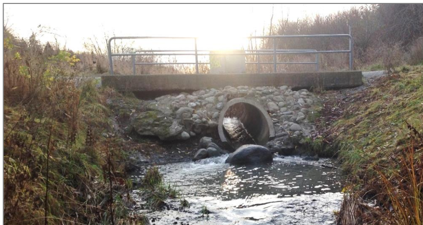
Sluttande kulvert under bro, Nälsta dike/bäck. Foto: Ekologigruppen
