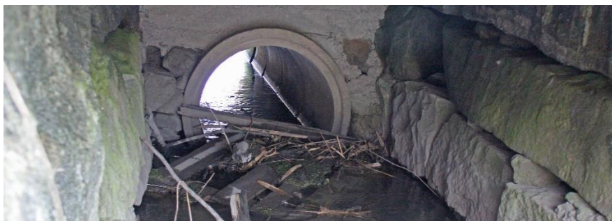
Kulvert under bro där skräp samlas, Eneby. Foto: Ekologigruppen
