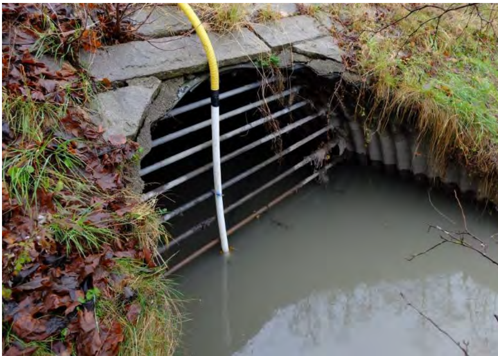
Figur 19. Vandringshinder VH3:1 består av galler vid utloppet från en kulvert. Foto: Emåförbundet
