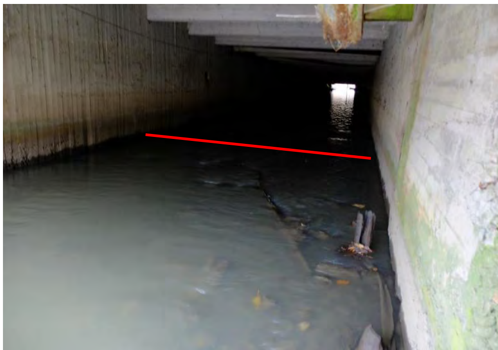
Figur 11. Kulvert vid inlopp till Solvalla, mindre betongklack utgör vandringshinder VH1:2. Klackens ungefärliga placering är markerad med en röd linje. Foto: Emåförbundet
