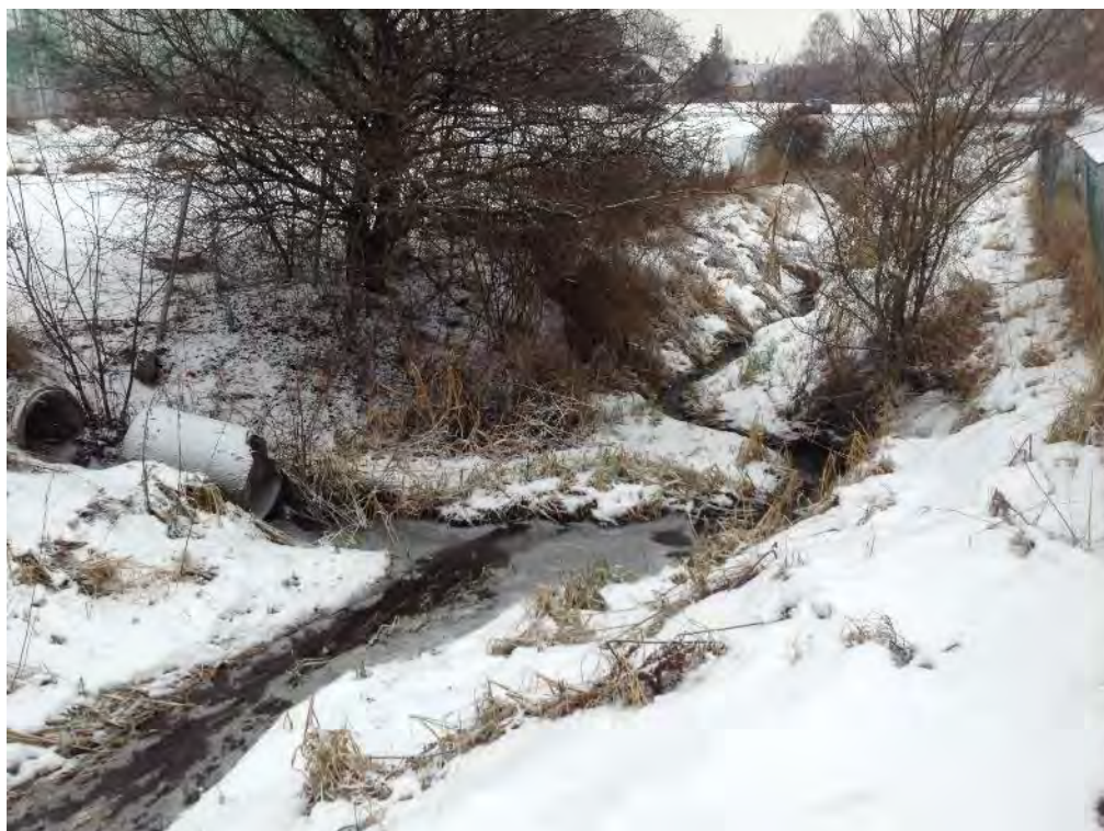
Figur 34. Dagvattenledning som mynnar direkt i vattendraget vilket skapar erosion på motsatt kant.
