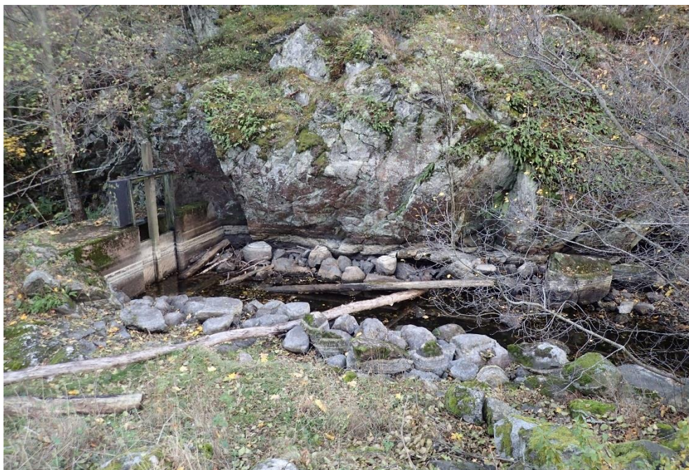
Figur 25. Krondammen belägen i det vänstra utloppet av sjön Tyresö-Flaten. Tidigare fanns ett skibord till vänster om befintlig dammbyggnad. Norconsult, 27 oktober 2016.
