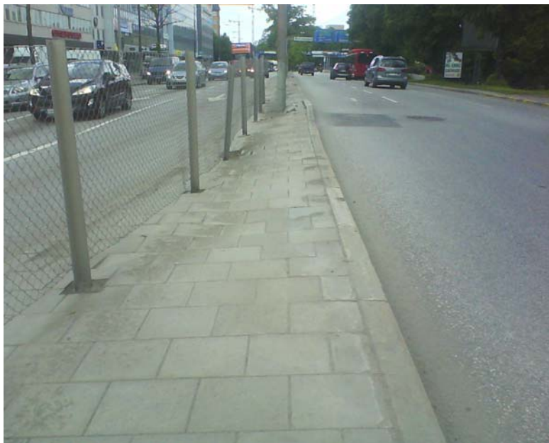
Figur 3. Sättningskador vid Roslagstull/Norrtull juni 2012.
